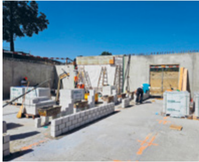
Erste Mauern werden gestellt. Die Einteilung der Garderoben sowie der Ausgang zum Fussballfeld Grünau werden sichtbar.
